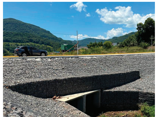
Galeria pluvial e taludes revestidos com gabiões: sistema triplicou a capacidade de vazão no local
